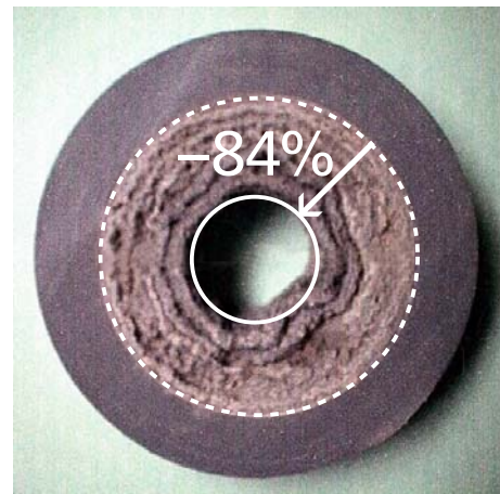
【Fig-02 スケールの堆積した塩ビ配管】
