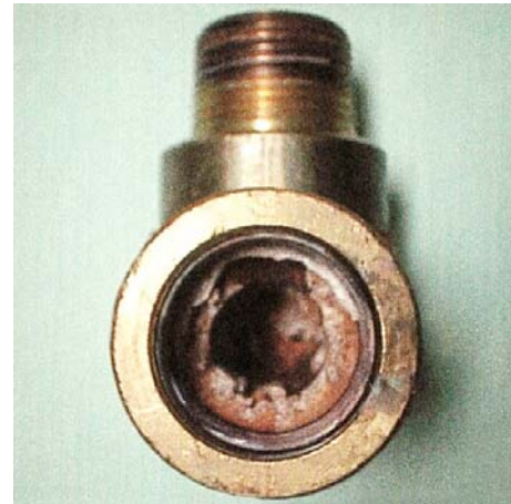
【Fig-01 スケールの堆積した温調機配管】
